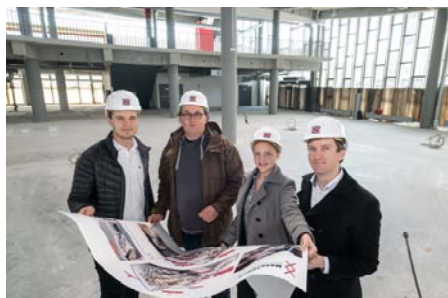
Projektleiter Thomas Abrell (rechts), Volkswagen AG, besichtigt gemeinsam mit Christian Cordes (2.v.l. links), Stadt Wolfsburg, und Christopher Schielke (links), VfL Wolfsburg, die Umbaumaßnahmen in der Markthalle. Julia Wenzel (2.v.r.) von NEULAND erläutert die bevorstehenden Bauarbeiten.
